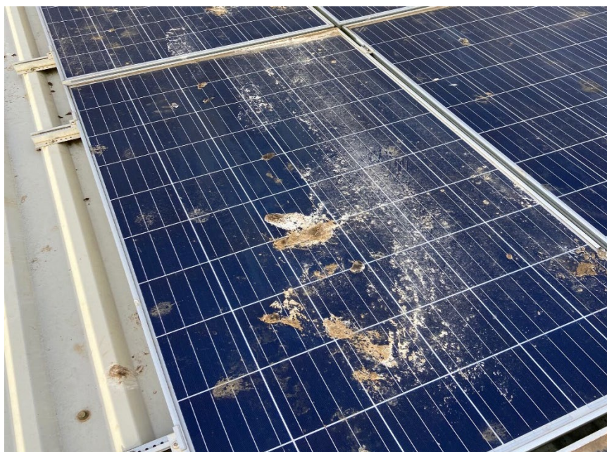
Рисунок 1.2 – Загрязненная солнечная панель
