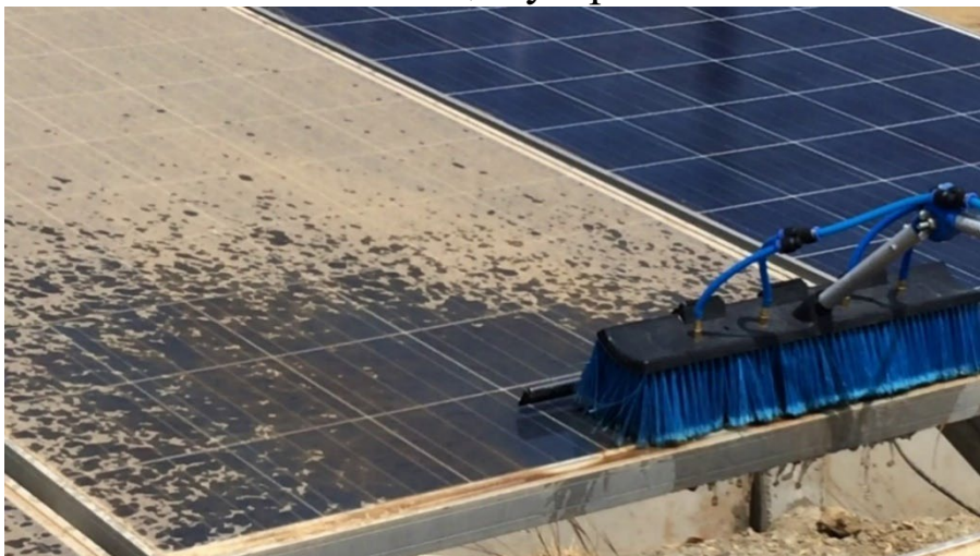
Рисунок 1.3 – Загрязненная солнечная панель
